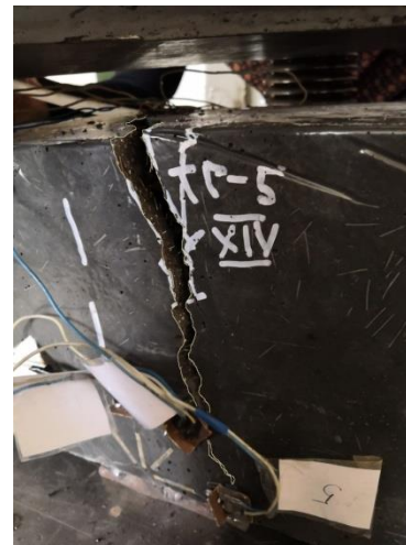
Рисунок 3 - Трещина в балке в момент разрушения
