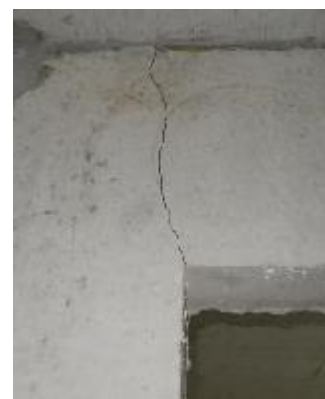
Рисунок 16 – Фотография стеновой панели второго этажа с вертикальной трещиной в надпроемной перемычке
