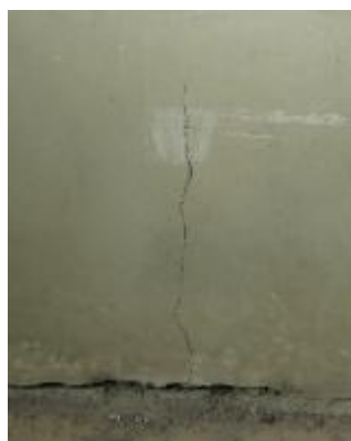
Рисунок 15 – Фотография стеновой панели второго этажа с вертикальной трещиной в опорной зоне
