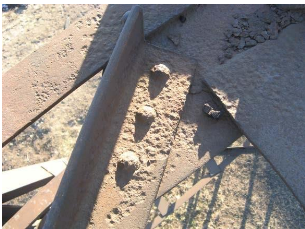
Рисунок 4 – Язвенная коррозия, коррозия пятнами на элементах кольца (глубина коррозии до 2,5 мм)
