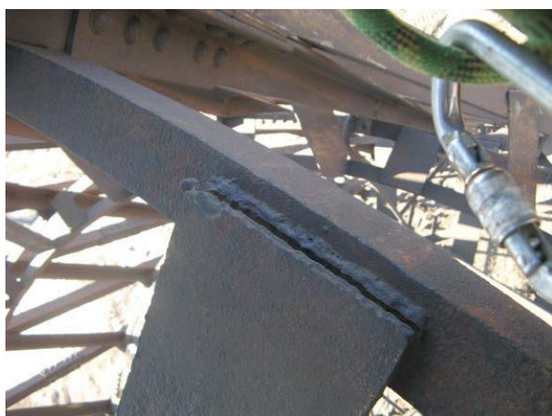
Рисунок 8 – Разрушение сварных швов соединения листов усиления с элементами кольца. Щелевая коррозия (глубина коррозии до 2 мм)
