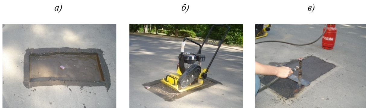
Рисунок 2 – Ремонт выбоины на дорожном покрытии: а – подготовленная ремонтная карта; б – уплотнение смеси виброплитой; в – термическая обработка поверхности покрытия
