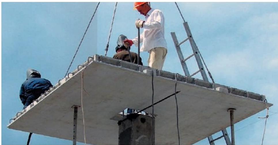
Рисунок 4 – Процесс центровки отверстия надколонной плиты относительно колонны в системах КУБ-2,5 и КБК, выполняемый с помощью лома
