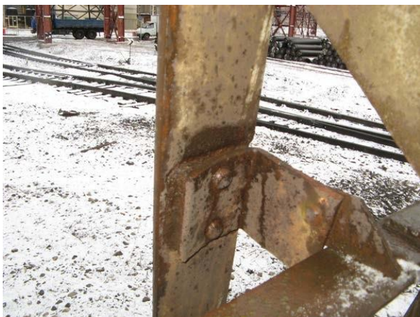
Рисунок 6 – Щелевая коррозия в узле крепления ноги (глубина коррозии до 4 мм)
