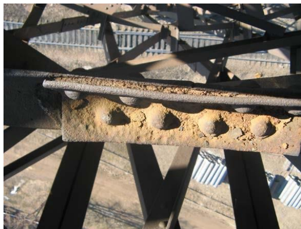
Рисунок 5 – Щелевая и поверхностная коррозия в узлах стыка обвязочных колец по внутреннему и внешнему рядам подкосов (глубина коррозии 1 мм)
