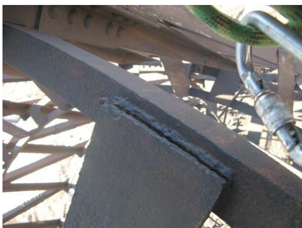
Рисунок 8 – Разрушение сварных швов соединения листов усиления с элементами кольца. Щелевая коррозия (глубина коррозии до 2 мм)
