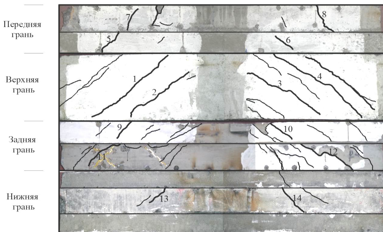
Рисунок 2 – Характер разрушения железобетонных образцов по пространственным сечениям
